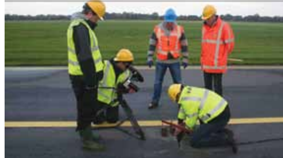
CEDD verlichtingssysteem voor Groningen Airport Eelde
